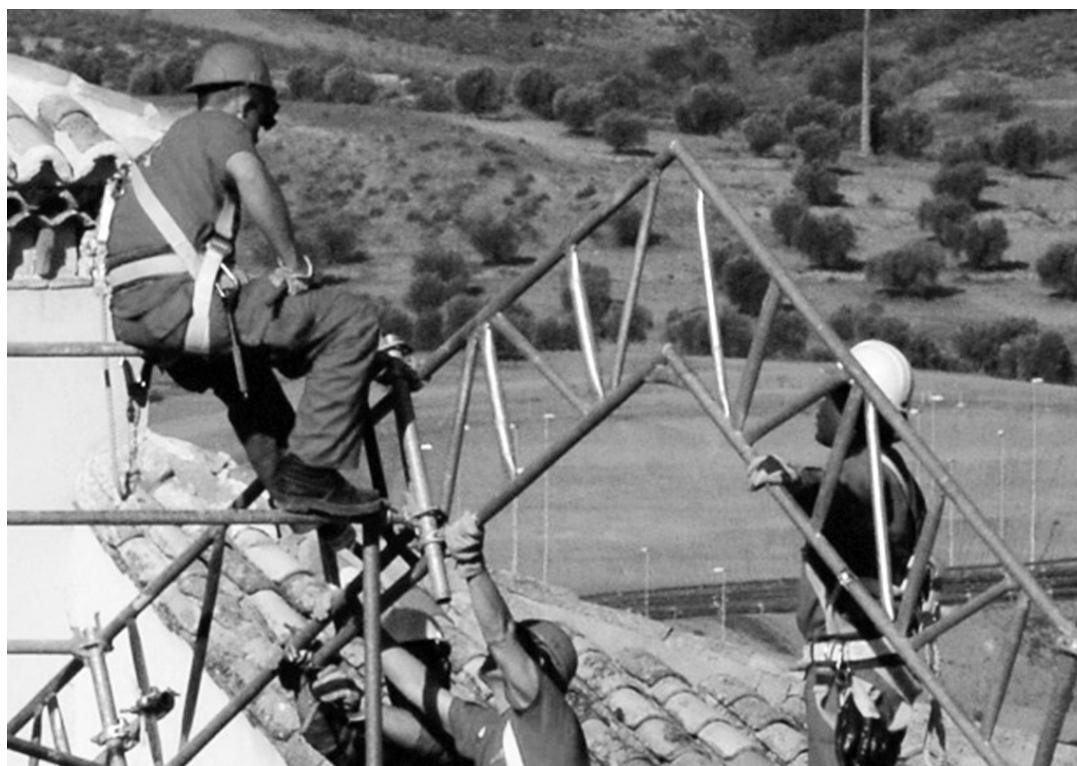
Construcción es uno de los sectores que concentra la mayor siniestralidad laboral.
